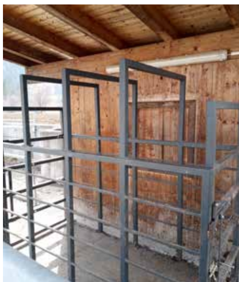
Die neue Viehwaage im Bereich der Greimhalle.
